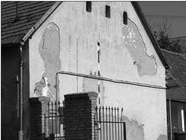
Felújításra szoruló iskolaépület
